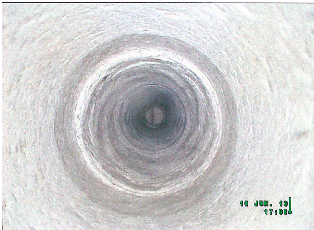
Abbildung 5: Foto aus der Kamerabefahrung; Scherband bei Bohrlochteufe 21,0 m
