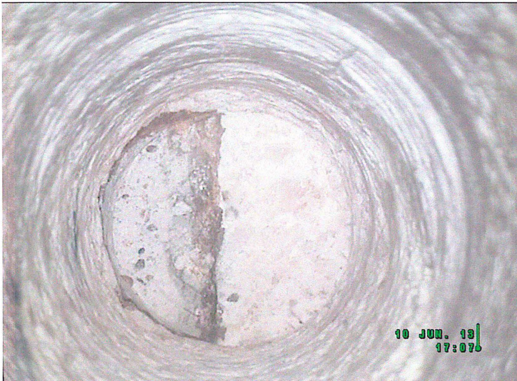
Abbildung 6: Foto aus der Kamerabefahrung; freigelegte Betonhülle bei Bohrlochteufe 22,5 m
